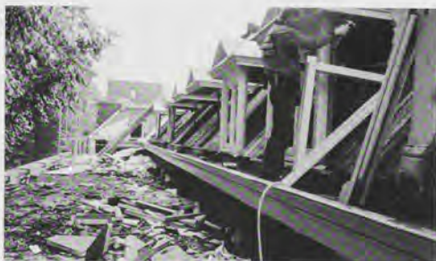
"Zo bleek het dak in veel slechtere staat te verkeren dan was verwacht".
